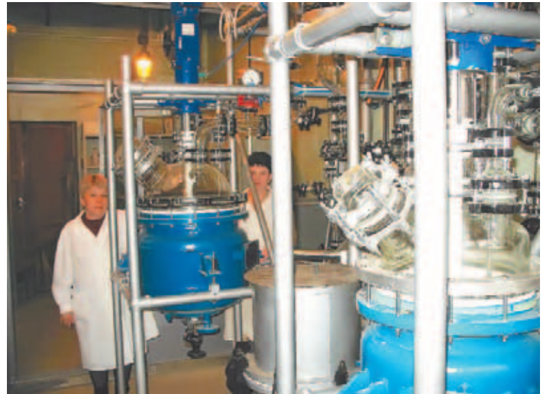
Установка по производству антисептиков. 2009 г.
